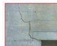
Enduit ciment sur une maçonnerie ancienne : fissurations
