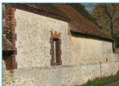
Enduit à pierre vue au premier plan de la construction, et enduit couvrant au second plan. Saint-Ange et Torçay.
