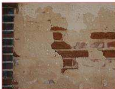
Ancien enduit ocre rouge et brique.
