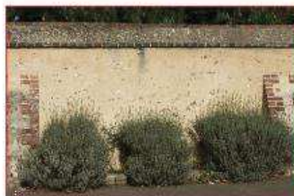
Mur de clôture en bauge avec chaperon maçonné et contreforts en brique, Escorpain
