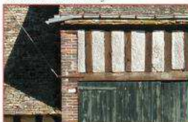
Colombages protégés par un lait de chaux.
