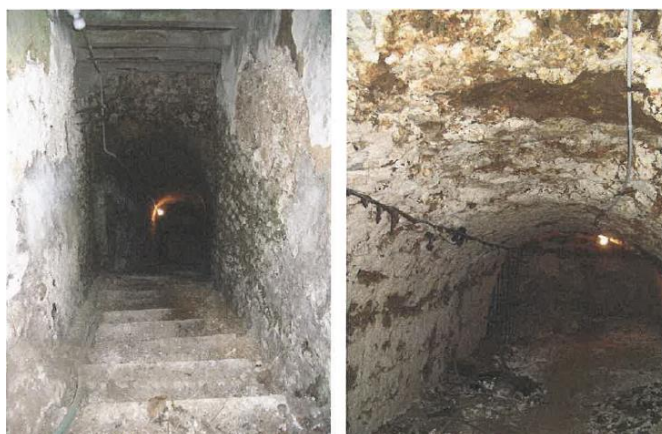
Source : Rapport d'expertise – BRGM-65090-FR, septembre 2015
