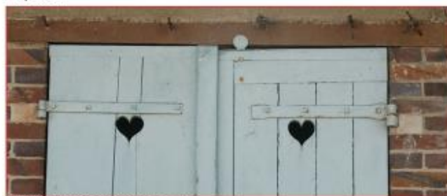
Jour de ventilation en forme de cœur
