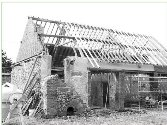
Au dessus : la grange en cours de travaux de rénovation, au printemps 2005.
