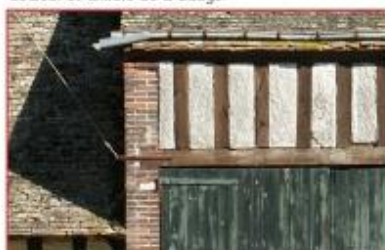
Colombages protégés par un lait de chaux
