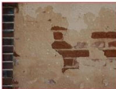
Ancien enduit ocre rouge et brique.
