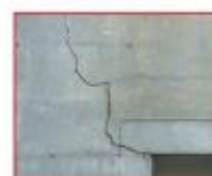
Enduit ciment sur une maçonnerie ancienne : fissurations
